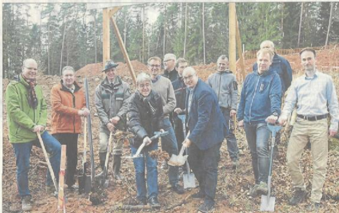
Bis zum Sommer sollen am Angersbacher Steinberg fünf knapp 200 Meter hohe Windräder entstehen. Projektentwickler Hessen-Energie bat am Montag die Beteiligten Institutionen zum symbolischen Spatenstich. Foto: Walter Kreuzer
